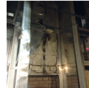
기본 Kingspan BENCHMARK Karrier 패널을 노출시키기 위해 알루미늄 카세트가 녹아 버린 것으로 보이는 테스트 종료
