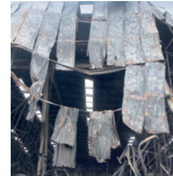
심하게 변형된 강철 구조물에 매달린 지붕 시트.
