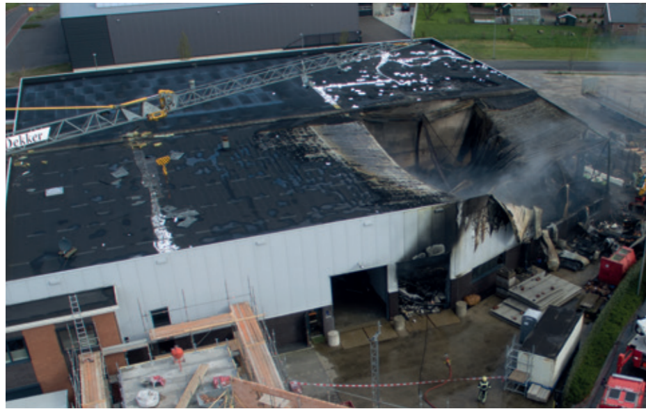
육군 잉여 창고의 구조적 붕괴를 보여주는 피해의 항공보기.
